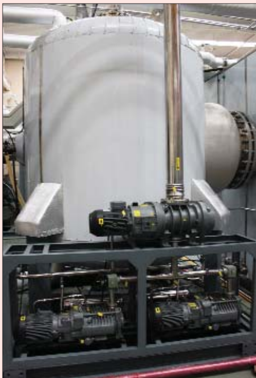
Рис. 4. Два винтовых компрессора и система двойного теплообмена
